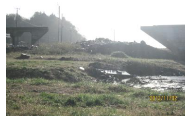
途切れたままの南三陸鉄道の鉄橋
